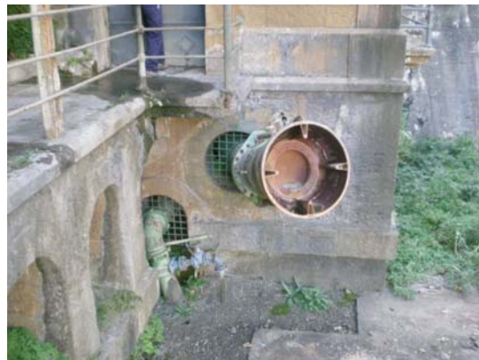
Punto toma Mancomunidad
