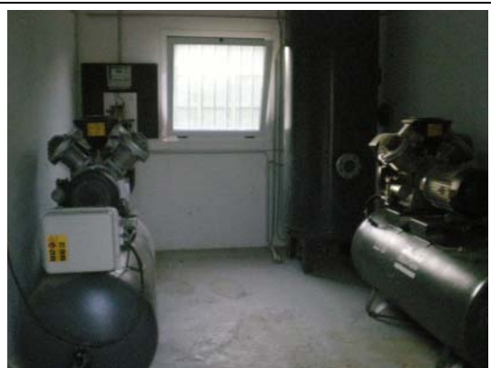
Sala de compresores ETAP
