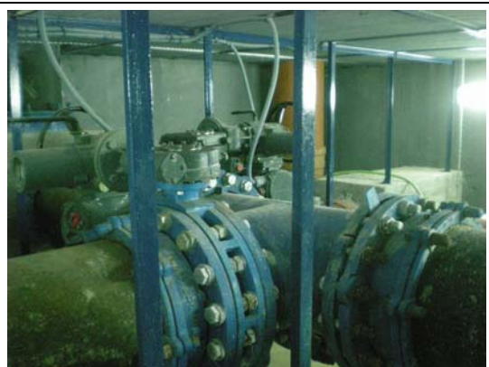
Sala de llaves ETAP
