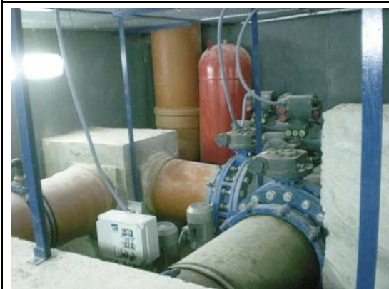
Sala de llaves ETAP
