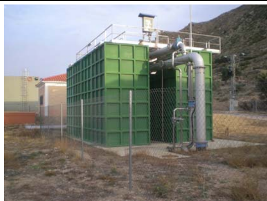
Zona de filtrado ETAP
