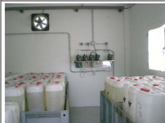
Sala de Cloración ETAP
