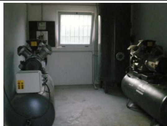
Sala de compresores ETAP
