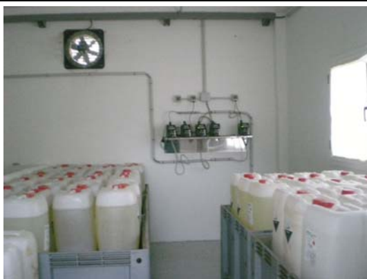
Sala de Cloración ETAP
